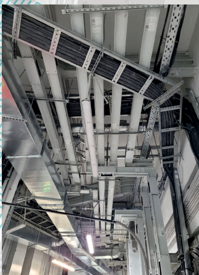
Апарт-отель «YES ТЕХНОПАРК» г. Москва Магистральный и распределительный шинопроводы Е3, 4000А, 1600А, 1250А, 0.4кВ, IP55
